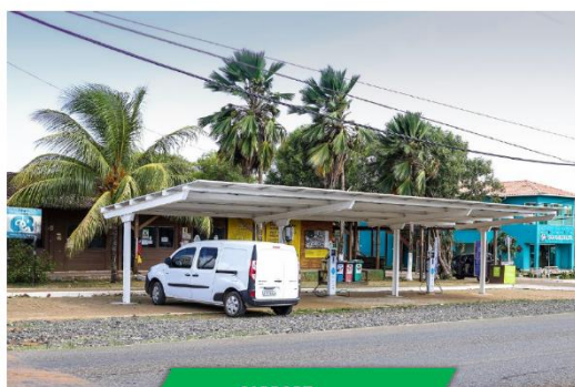
CARPORT ECOPOSTO PÚBLICO PARA O CARREGAMENTO DOS CARROS ELÉTRICOS
